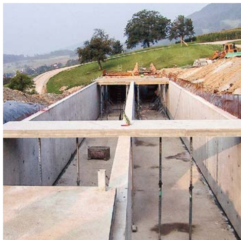
| Spezialbauwerk: Jauchegrube bei einem Landwirtschaftsbetrieb
